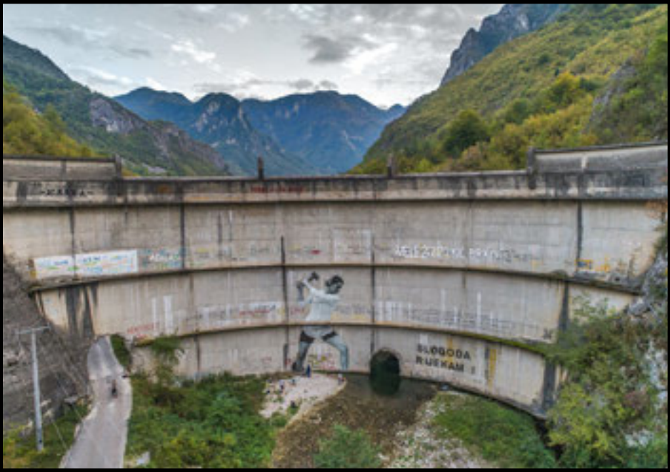
Le barrage d’Idbar a été construit en 1959, puis mis hors service peu après, lorsque la rivière Baščica a commencé à le fracturer. Cette structure en ruine est devenue le symbole de notre campagne « Save the Blue Heart of Europe ». Konjic, Bosnie-Herzégovine.
