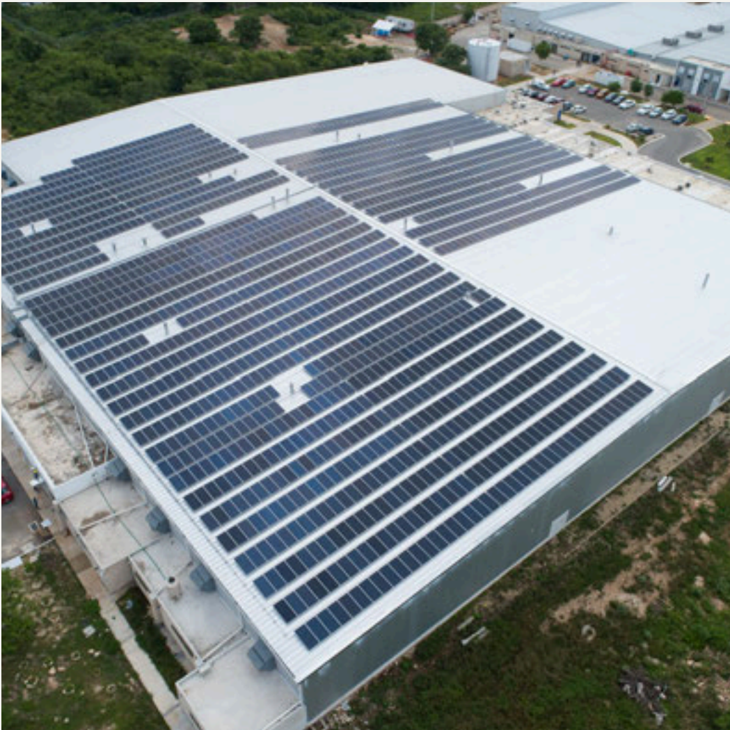
Des panneaux solaires couvrent le toit de l’usine Vertical Knits, un partenaire de notre chaîne d’approvisionnement fabriquant certains de nos t-shirts et chandails en coton biologique. Baca, Mexique.
